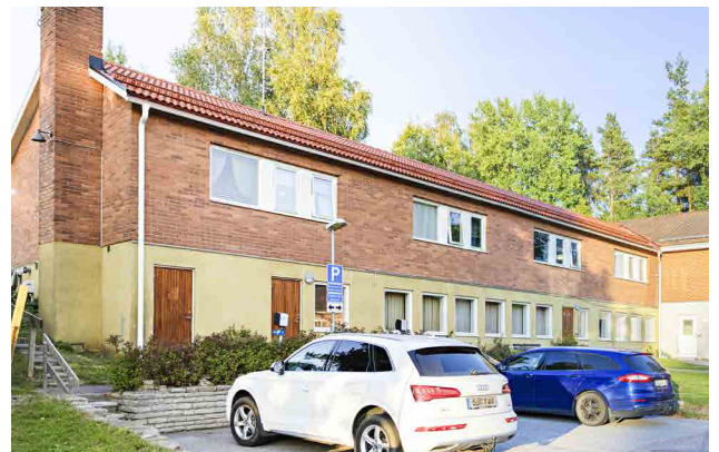
Trappan ner till parkeringen på Enebacksvägens gavel i Sättrabrunn ska bytas ut.
